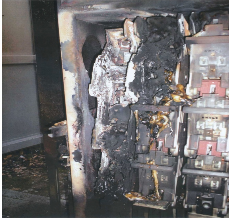
Figura 5. Daño provocado por fallas eléctricas en instalaciones. Fuente: Energy Management (2014).
